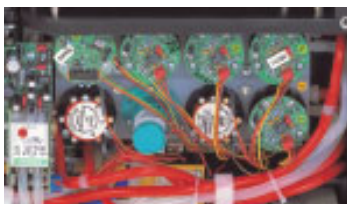
Vue montrant les cellules de mesure
